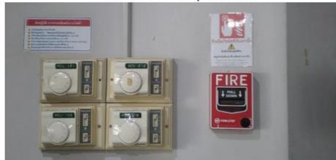
และระบบแจ้งเหตุเพลิงไหม้
